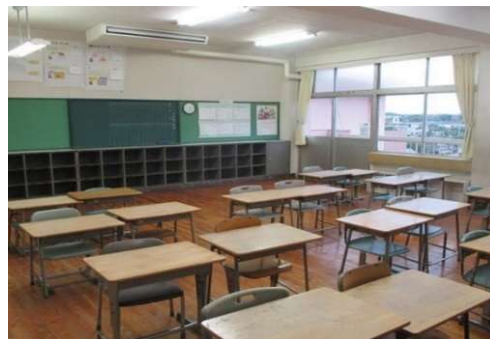
佐倉市立小中学校・幼稚園 空調設備整備事業
