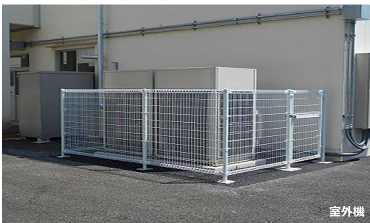
小学校エアコン
