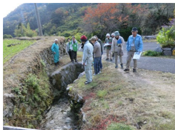
現地での危険箇所確認
