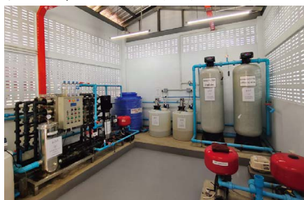
施設内部の浄水設備の設置状況 ヤンゴン市サウスダコンタウンシップ
