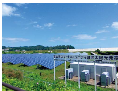
田老太陽光発電所(岩手県宮古市)
