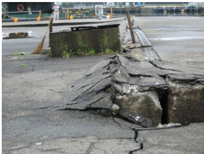
岸壁背後の盛り上がり
