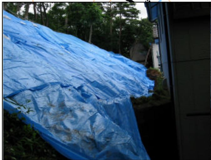
家屋裏側の擁壁の変状
