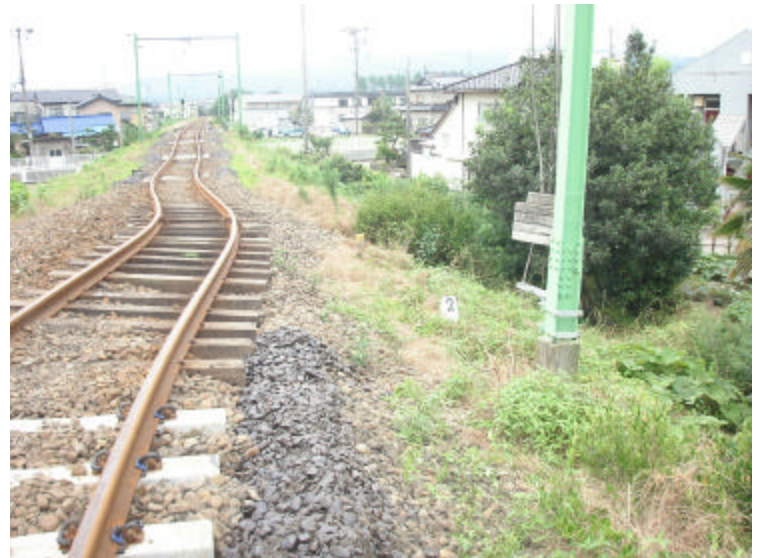
変状箇所の拡大写真
