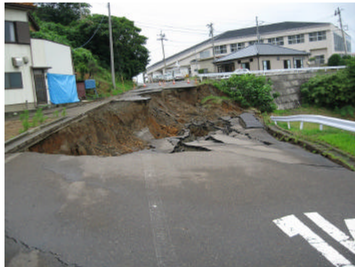
笠島駅南側道路の崩壊
