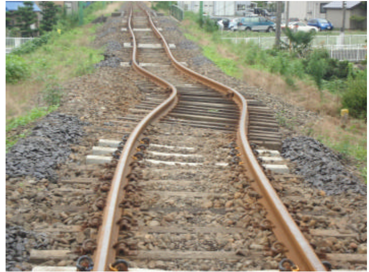
変状箇所の拡大写真
