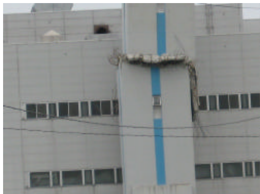
煙突の破断部分
