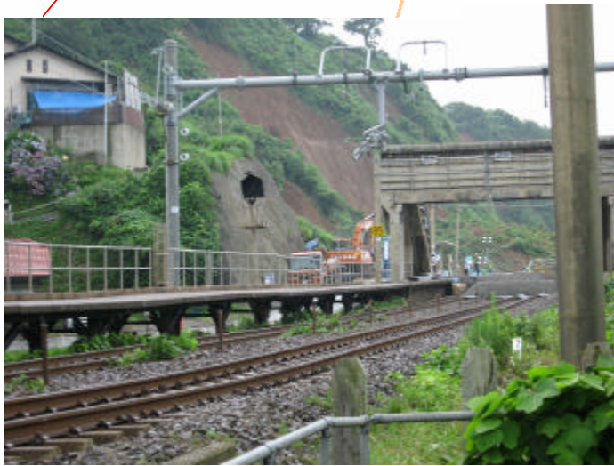
青海川駅背面斜面の崩壊
