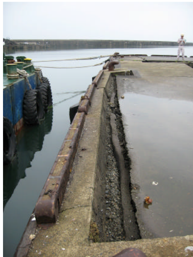
岸壁のせり出し
