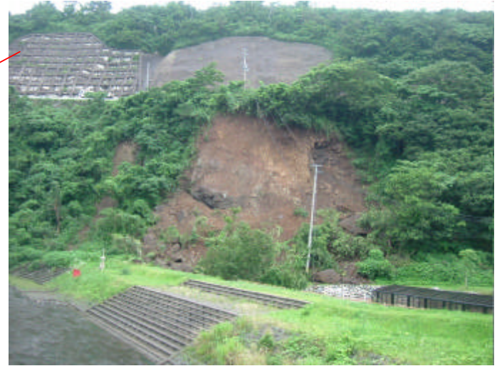
柏崎さけのふるさと公園背面斜面の崩壊
