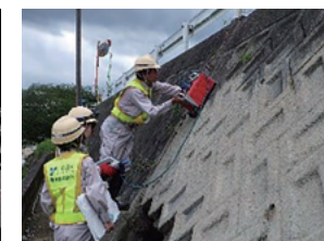
護岸の変状調査
